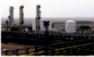
محطة تنقية مياه شكل (١٥)
